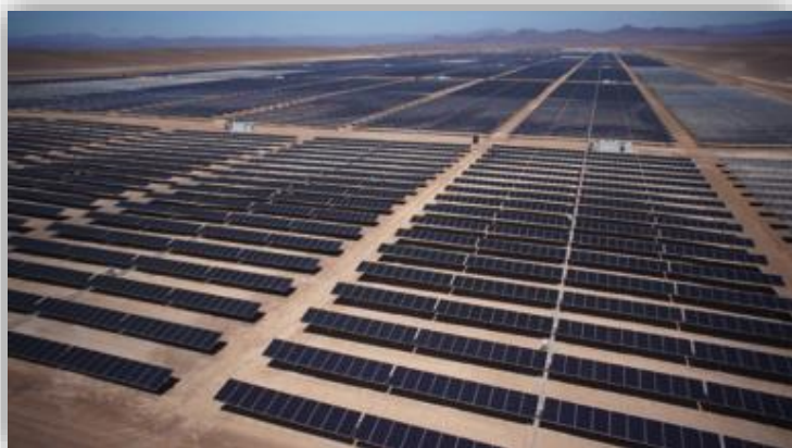
Atacama, Chile – 70 MW Salvador
