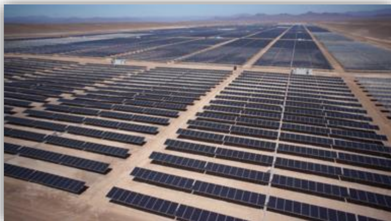
Atacama, Chile – 70 MW Salvador
