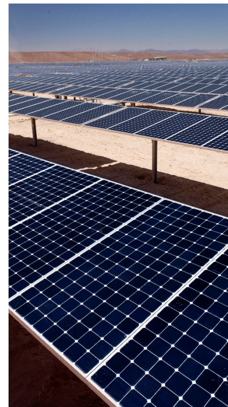
Atacama, Chile – 70 MW Salvador
